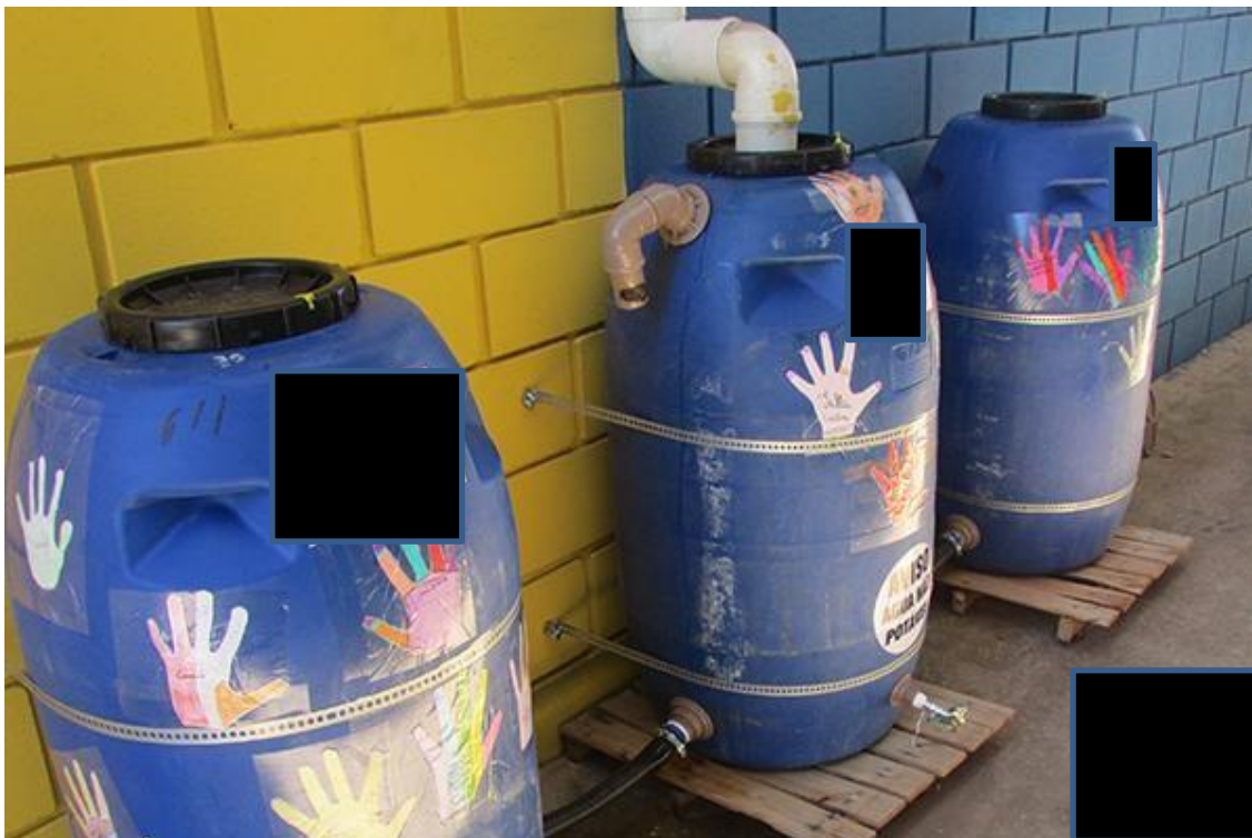
Figura 26. Reservatórios com água das chuvas. Foto: elaborado pelo Autor do trabalho.
